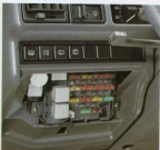
Die zentrale Anordnung von Relais und Sicherungen.
