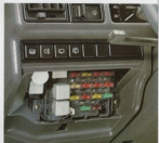
Die neue zentrale Anordnung von Sicherungen und Relais ist leicht zugänglich und übersichtlich.
